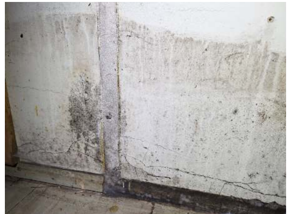
4. Kosteuden aiheuttama vaurio.
