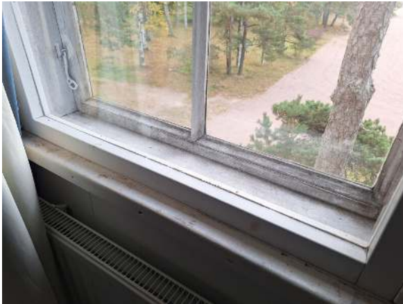
31. Ulomman ikkunapuitteen sisäpinnalla mikrobikasvua
