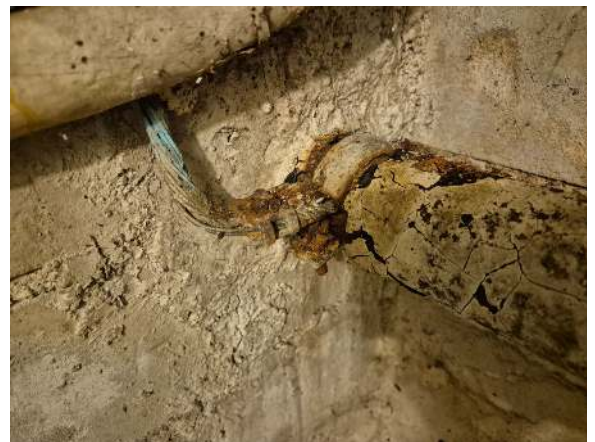
126. Putkiston hapettunut maadoitus.
