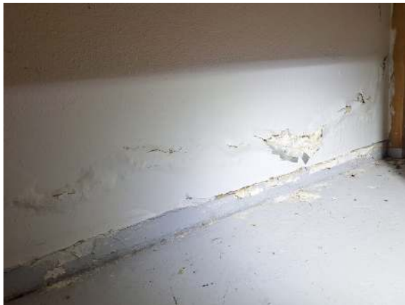
3. Kosteuden aiheuttama vaurio.
