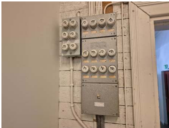
121. Sähkökeskus, noin 1960-luvulta.
