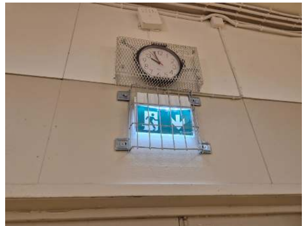
142. Liikuntasalin poistumistievalaisin on uusittu.
