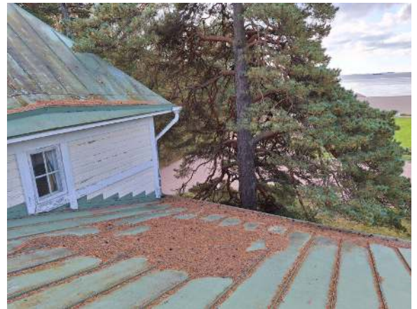
10. Havuja kerääntynyt katolle
