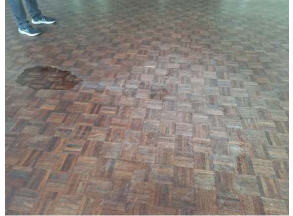
2. Kosteuden aiheuttama vaurio.
