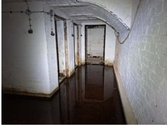
1. Kosteuden aiheuttama vaurio.
