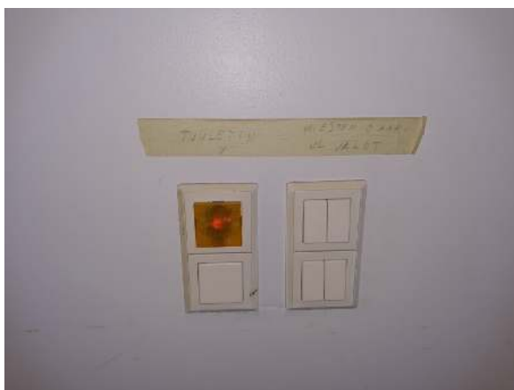
92. Ilmanvaihdon ohjaus (kanavapuhallin).
