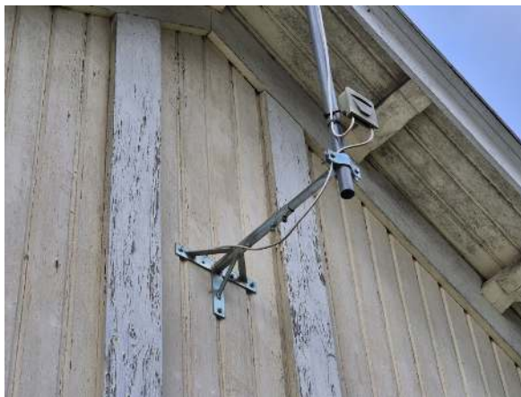
125. Harava-antennista puuttuu maadoitus.
