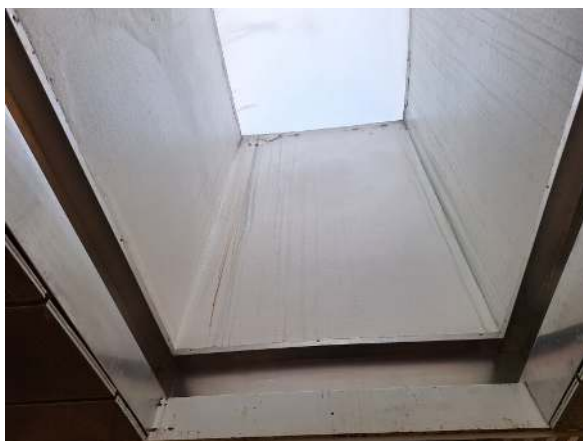
5. Kosteuden aiheuttama vaurio.
