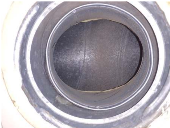
100. Poistokanavassa lievää pölykertymää.
