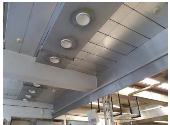
108. Tulo- tai korvausilmaventtiileitä keittiössä.
