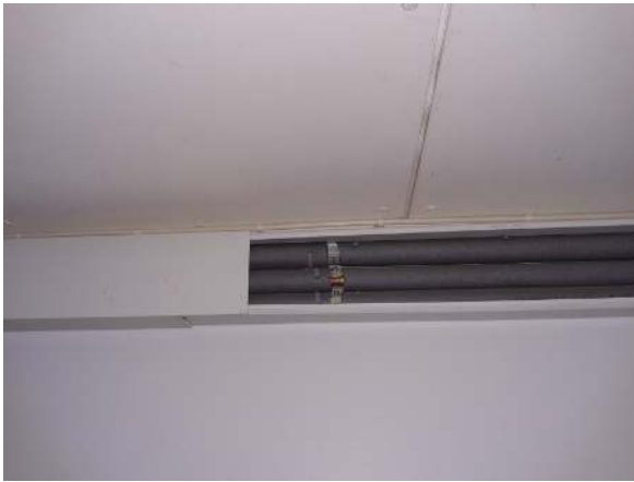
70. Eristettyjä vesijohtoja (kuparia).
